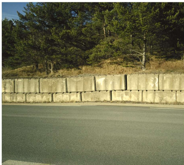
Figure 25 : Déformation longitudinale du mur n°1 (photographie Cerema du 22/01/2016)
