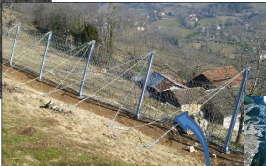
Barrière de protection Ecran Filets Pare Blocs
