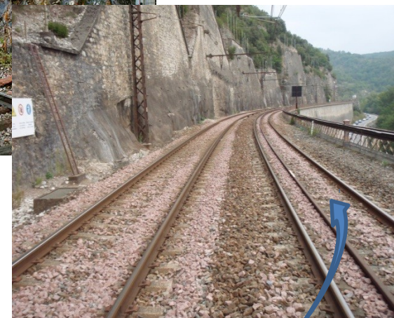
Barrière de réduction Rails de sécurité
