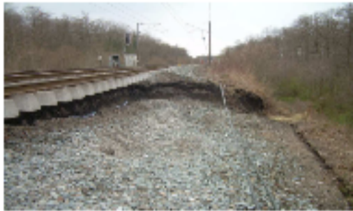
ECR 4 Désordres affectant voie
